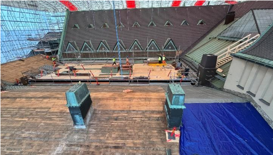
Kuva 5. Virastosiiven ja Kansantieteellisen osaston katoilta on poistettu vanhat kuparipellit. Vanhat pellit kunnostetaan ja ne käytetään uudelleen osalla lappeita. Telineasennukset käynnissä Halkopihan päällä.
