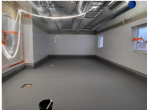
Kuva Keittiötilojen Ucrete-massalattia
